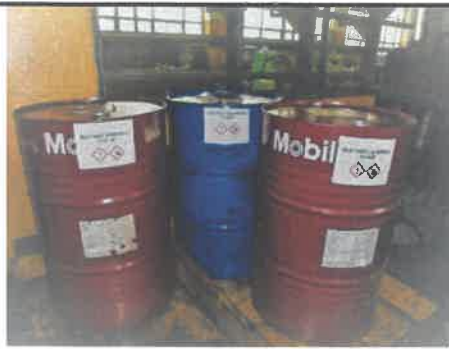
Butoaie pentru colectare ULEI UZAT 13 01 10* - ulei uzat hidraulic 13 02 05* - ulei uzat de motor, de transmisie
